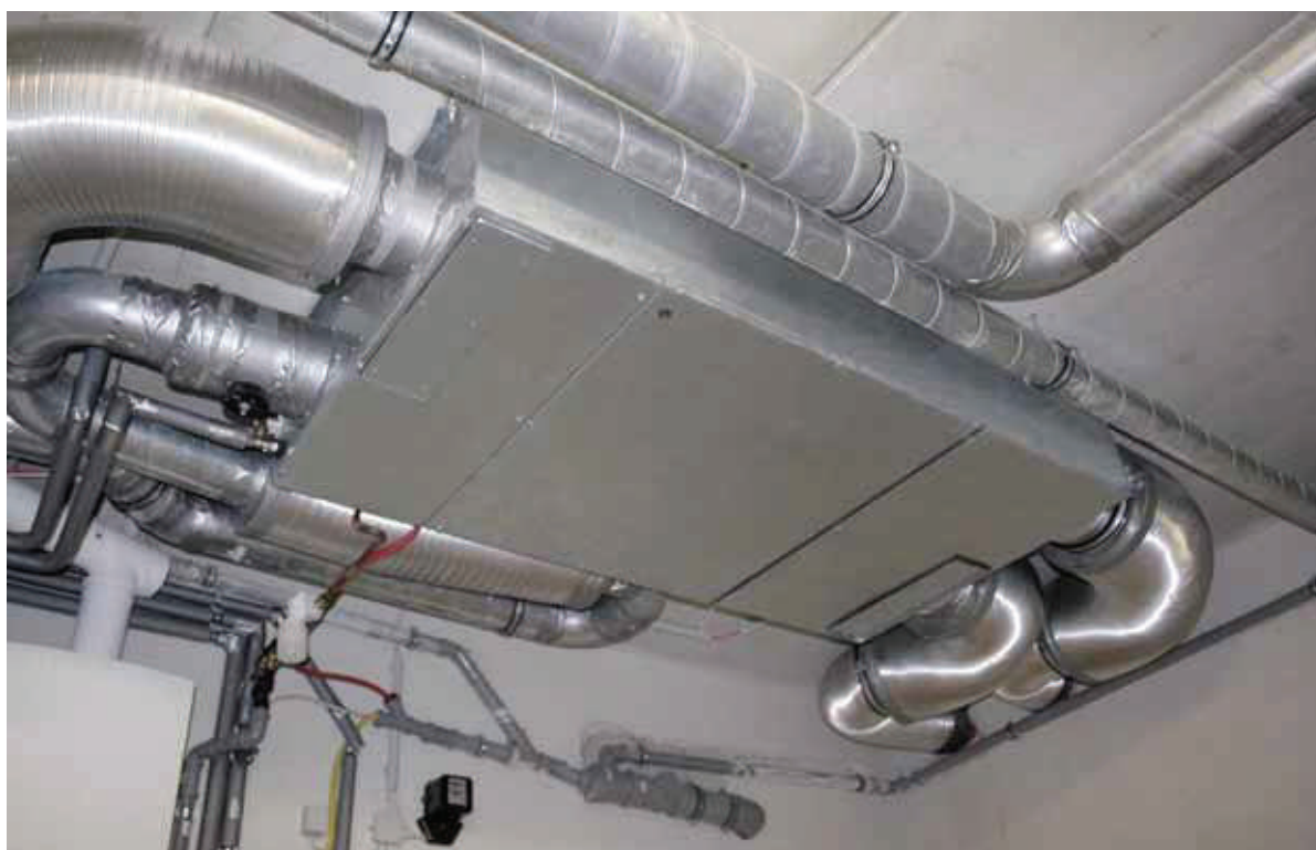
Afbeelding 3: Een bestaande plafondunit met indirecte verdampingskoeling.
